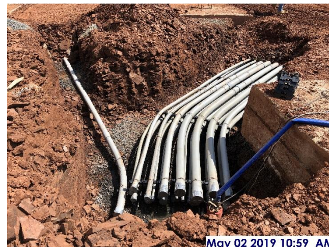
Underground electrical conduit
